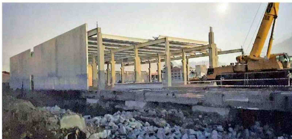
La Carpenteria sta prendendo forma. Il cantiere del nuovo stabilimento Coms, nell'area Ex Franzoni di Esine
